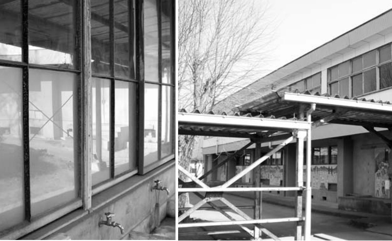
古くなった学校施設(左: 男衾中学校舎の窓 右: 折原小体育館)
