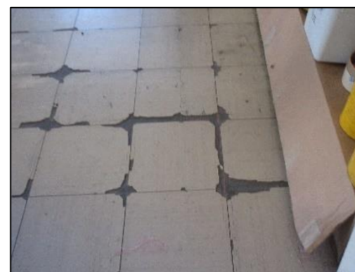
廊下：タイル剥がれ
