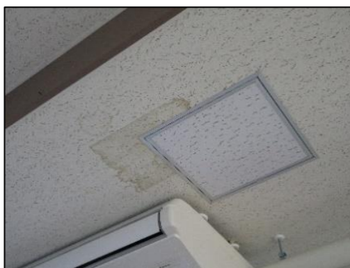
天井雨漏り跡
