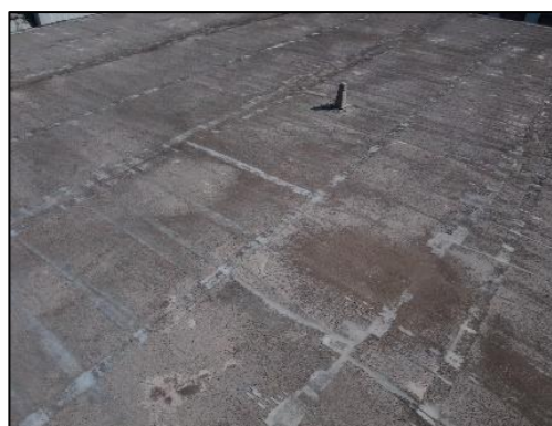
屋上防水保護モルタル劣化
