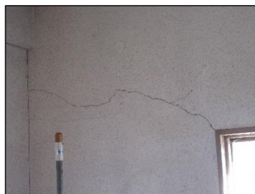
壁面ひび割れ
