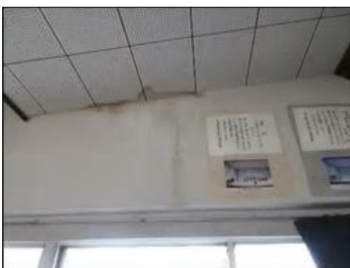
天井雨漏り跡
