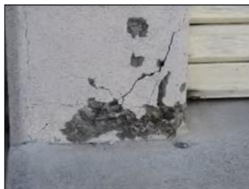
ひび割れ、破損
