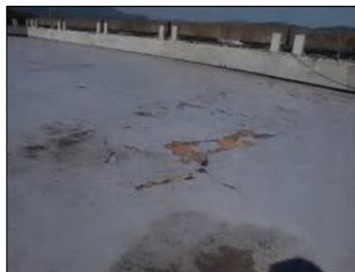
屋上防水トップコート剥離、穴あき
