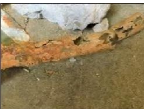
給水管錆、腐食
