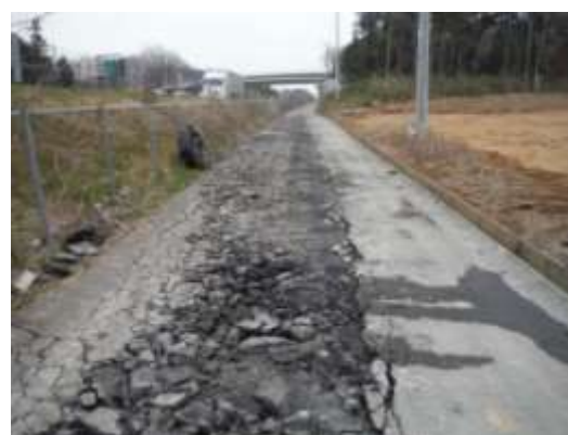
大型ダンプの通行で破壊された町道
