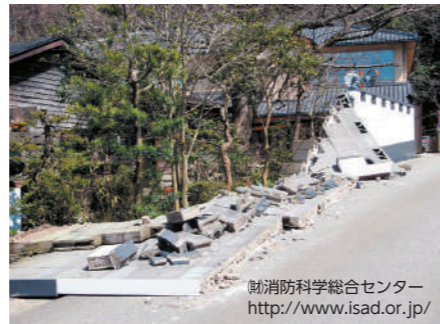
倒壊したブロック塀
