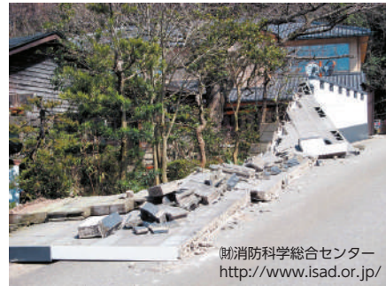
倒壊したブロック塀
