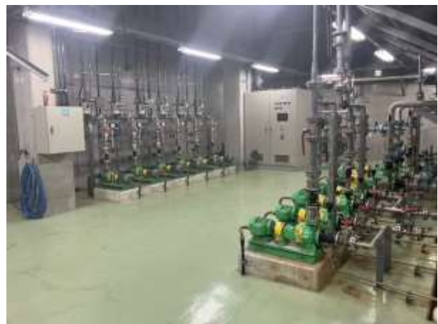
1. 汚泥再生処理センター 設備
